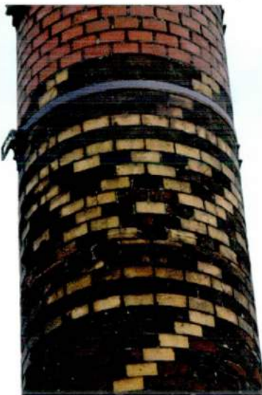
De overgang tussen oorspronkelijk en later toegevoegd metselwerk met de doorlopende getordeerde sierrand.
