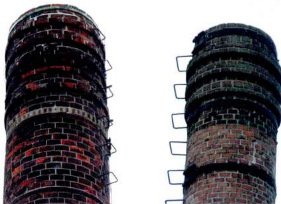
Links de schoorsteenkop in Rijssenhout met een reparatie-laag van andere stenen. Rechts de schoorsteenkop van het Badhuis van Amsterdam.
